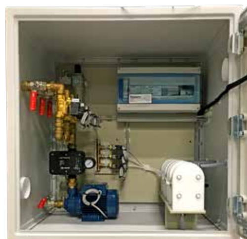
Armoire DPVR3 (3 stalles)
