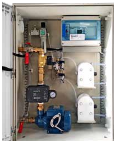
Armoire DPVR2 (2 stalles)
